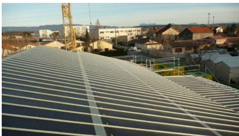
Panneaux solaires photovoltaïques Salle Fernand Léger
