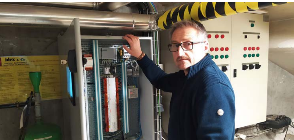
Chargé des bâtiments municipaux, Jean-Marc Basque nous montre le système de gestion du chauffage de la mairie.
